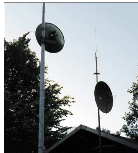
DB0LHR: Packet-Radio-Digipeater des OV Lahr-Schwarzwald (A08) – Antennenanlage, mit der die Verbindung zu DB0NKS und DB0OFB (je 0,7 W) aufrecht erhalten wird.
